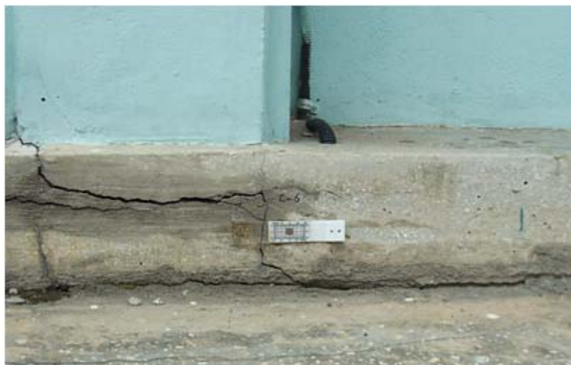
그림 3-61 지반침하에 의한 구조물의 균열 발생 및 균열 측정
